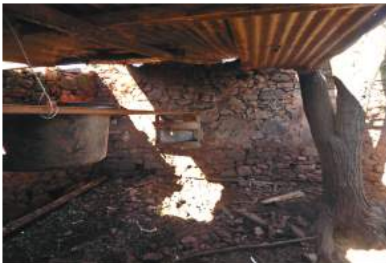
Adyacente al casco de la estancia vestigios muy deteriorados.
