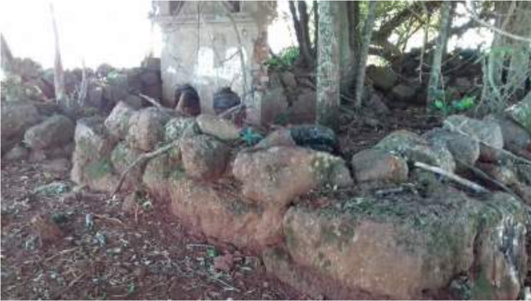
Figura 55 – Estrutura da Capela de São Jeronimo encontrada no interior de São Nicolau
